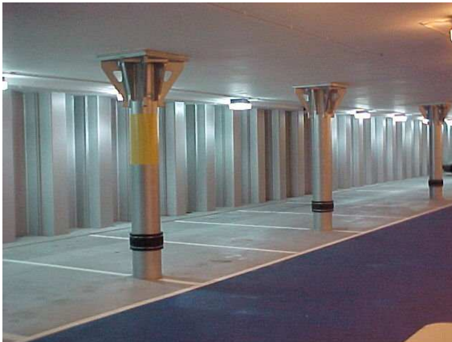
Rys. 6.1 Ścianka szczelna i słupy w konstrukcji parkingu podziemnego budowanej od góry w dół
